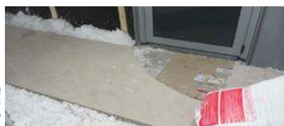
L'isolant situé derrière la porte a été enlevé pour permettre son ouverture
