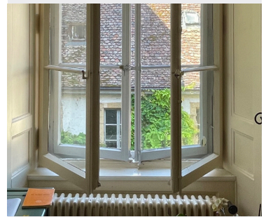
Double fenêtre avec simple vitrage
