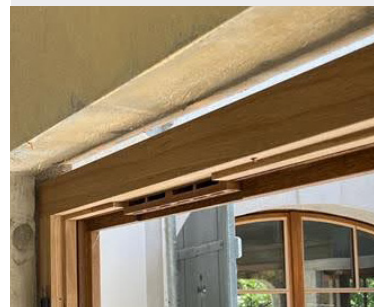
Intégration d'une grille de ventilation dans le cadre de la fenêtre
